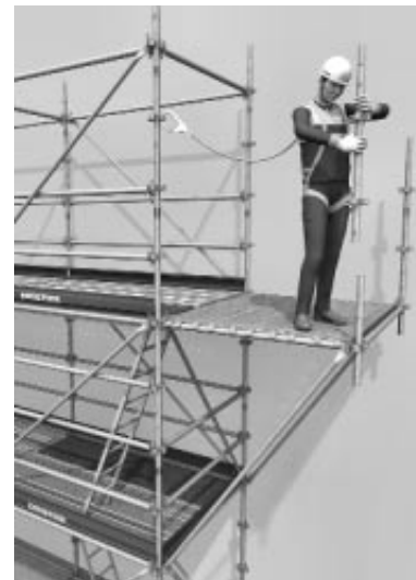
Mise en place des planchers dans le sens de la largeur , puis des montants, des gardes-corps et des plinthes.
